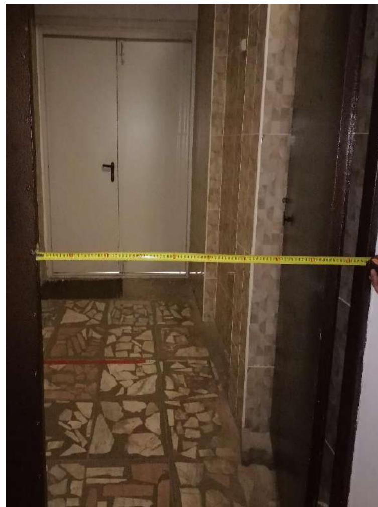
Фото № 14 Ширина входной двери тамбура
